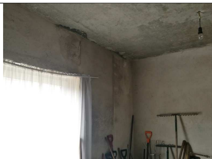
5 Widok lokalnego zawilgocenia ścian parteru w miejscu loggii
